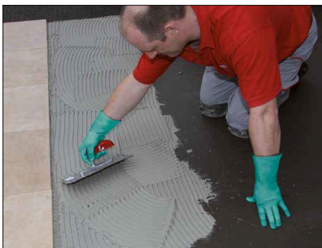
16 Het aanbrengen van de twee-componenten flexlijm Sopro megaFlex S2 of Sopro megaFlex S2 Turbo op de uitgeharde afdichting.
